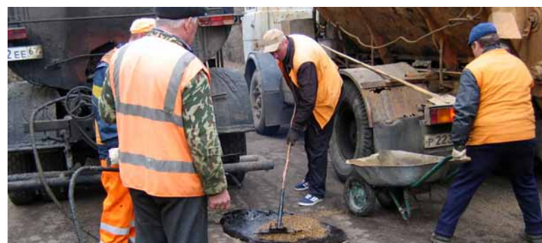
- На город мы выделили бригаду в количестве 5 человек и 3 единицы дорожной техники, - говорит главный инженер ОАО «ДЭП-3» А.В. Тростинский. - За
